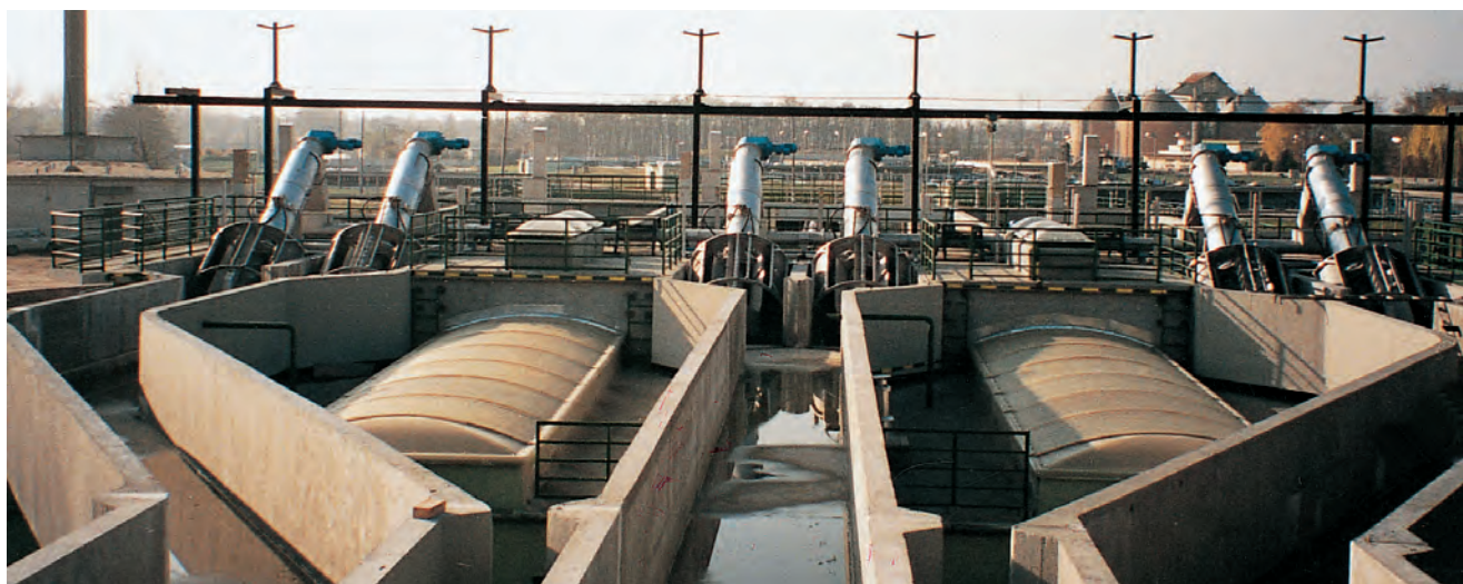
EDAR Budapest (Hungría): 6 Tamices ROTAMAT® Ro 1, diámetro = 2000 mm, paso = 10 mm, Q_{max} = 6 \times 2500 \text{ m}^3/\text{h} , instalación directamente en el canal, modelo protegido contra heladas.
