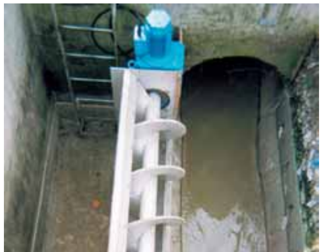
Tamiz HUBER ROTAMAT® RoK 1, tamaño 300, colocado sobre vertedero
