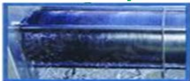
Zona de espesado
