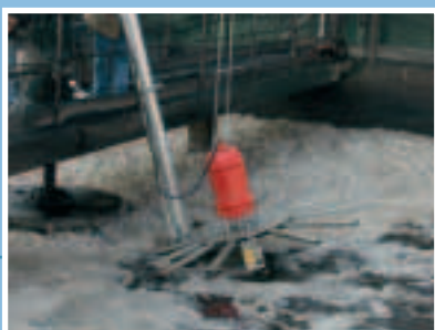
Phase d'immersion d'un aérateur SCL dans un bassin de cokerie. Fases de instalación de aireador sumergido modelo SCL.
