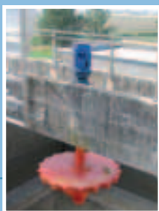
Aérateur de surface fixe type ASP-V, installé sur passerelle en béton. Instalación de aireador de superficie modelo ASP-V, versión fija.
