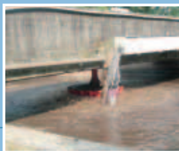
Aérateur de surface fixe type ASP-V, installé sur passerelle en béton. Instalación de aireador de superficie modelo ASP-V, versión fija.
